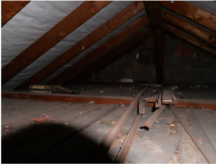
Abbildung 9: Dachstuhlkontrolle auf Kot, Fraßreste, Mumien
