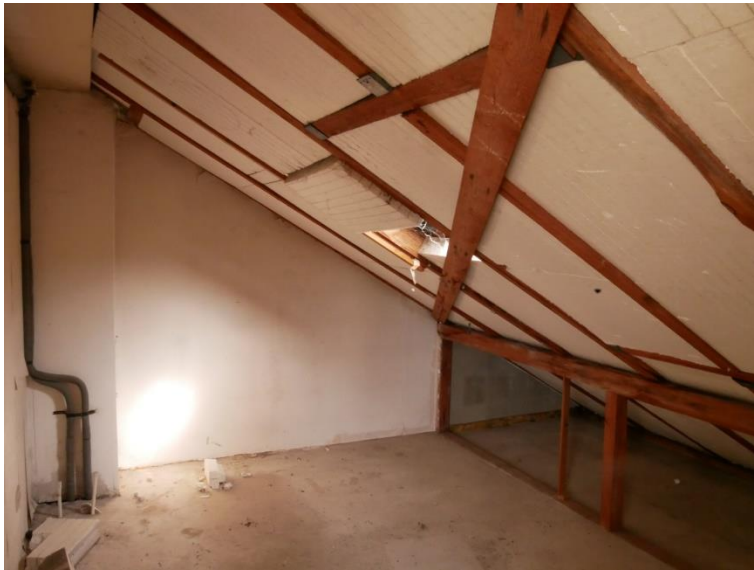
Abbildung 7: Dachstuhlkontrolle auf Kot, Fraßreste, Mumien
