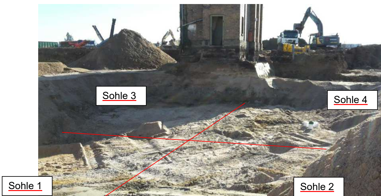
Abb. 4-1 Blick über die Baugrube auf südwestlicher Teilfläche, zwischen ehem. „Alte Rohbauhalle“ und dem Gebäude „Farb- und Lösemittelager“ mit Beprobungsfeldern (23.11.2022).
