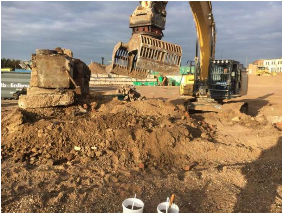
Abb.1 Blick auf den sensorisch auffälligen Boden im Übergangsbereich der Heizölleitung in das Gebäude.
