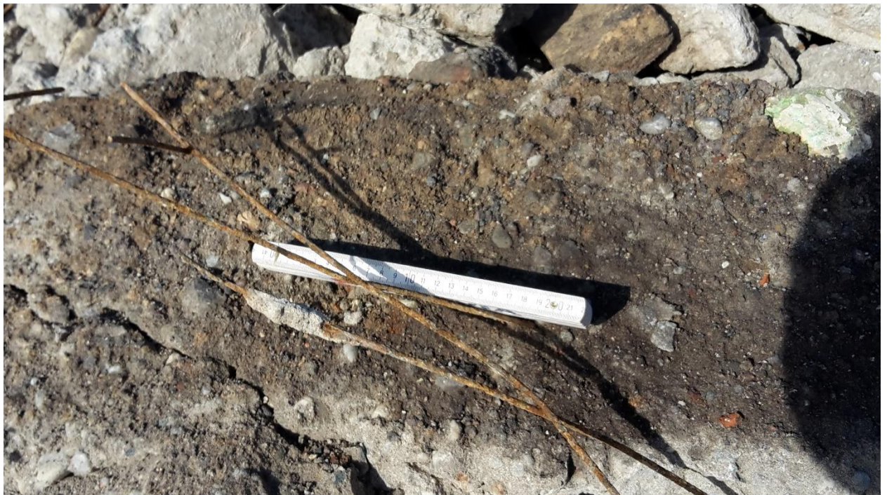
Abb.2 Detail: Verölte Oberfläche auf dem Betonaufbruch und Bewehrungsstählen.
