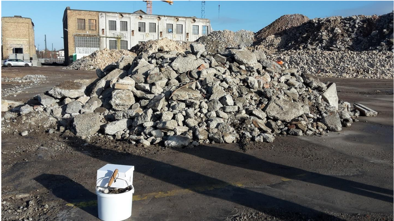
Abb.1 Blick auf das Haufwerk mit Bauschutt vom Rückbau der Bodenplatte mit dem Abspanntisch.
