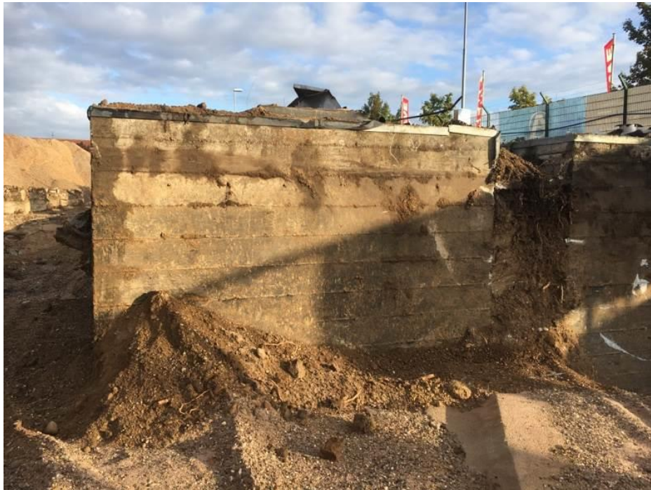
Abb. 1 Blick auf die Betonwannen mit den darin lagernden Heizöltanks, rechts verläuft die Scheffelstraße.
