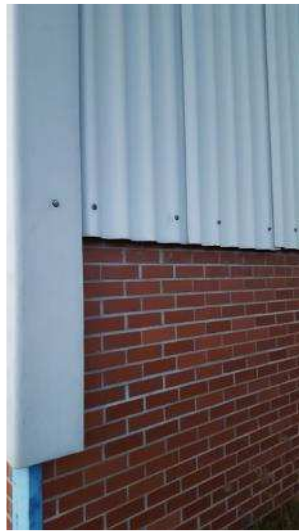
Foto 39: Potentiell für die Zwerg- fledermaus geeignetes Spaltenquartier an den im Untersuchungsgebiet befindlichen Gebäuden: Wandverkleidung
