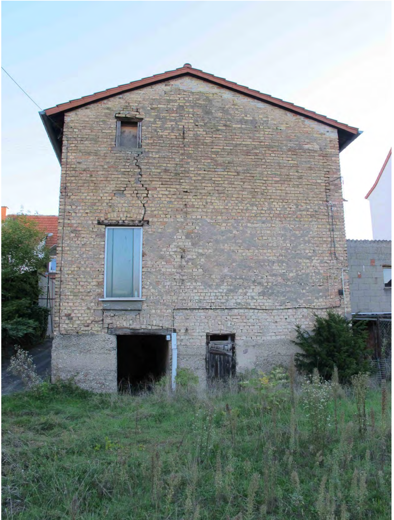
Bild 1: Gebäude an der Nordwest-Seite des UGs. Die Spalten und Zugänge des Gebäudes könnten planungsrelevanten Fledermausarten potentiell als Quartiere dienen.
